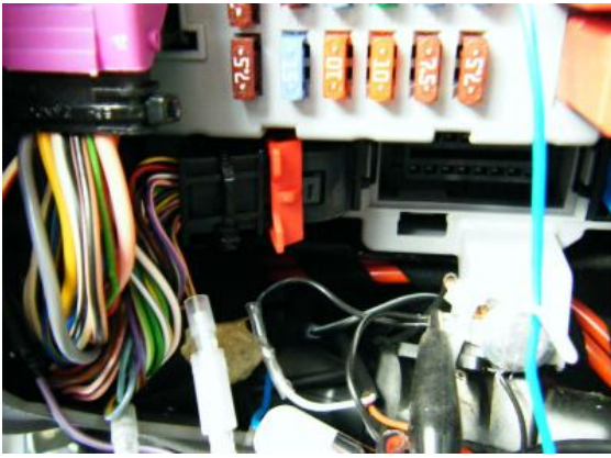
カバーを外すとヒューズ下のコネクタに「ピンク/緑」の線があるので切断しリレーへ
